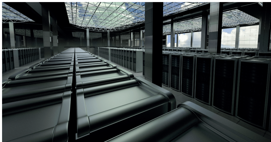
Datacenter Refroidissement liquide
